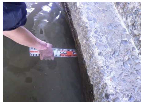
089. 地藏橋：RC床版橋 (橋長：5.70m、1984年竣工) 橋台基礎部の洗堀 ※基礎部の洗堀は、橋台の沈下・傾斜へと繋がる。(迂回路有り)
