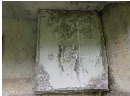
001. 後田下橋：プレテンT桁橋 (橋長：17.64m、1988年竣工) 横桁定着部の剥離、遊離石灰 ※雨水の浸入により、損傷は進行する可能性がある。(迂回路有り)
