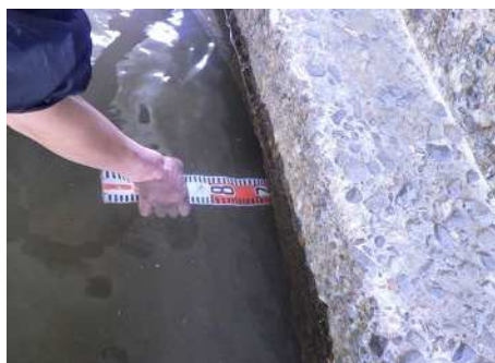
089. 地蔵橋：RC床版橋 (橋長：5.70m、1984年竣工) 橋台基礎部の洗堀 ※基礎部の洗堀は、橋台の沈下・傾斜へと繋がる。(迂回路有り)
