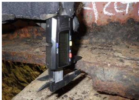
055. 大風第3号橋：鋼H桁橋 (橋長：10.44m、1968年竣工) 主桁端部の板厚減少を伴う腐食 ※支点上の板厚減少により、耐荷力の低下が推測される。(迂回路有り)
