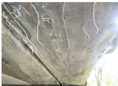
002. 亀久保：プレテン中空床版橋 (橋長：14.56m、1984年竣工) プレテン桁下面・側面のひびわれ ※雨水の浸入により、ASRの損傷は進行する可能性がある。(迂回路有り)
