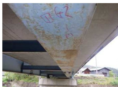
004. 青柳橋：鋼H桁橋 (橋長：31.68m、1982年竣工) 主桁・横桁の腐食 ※下フランジは錆が多数発生しており、腐食は進行する。(迂回路有り)
