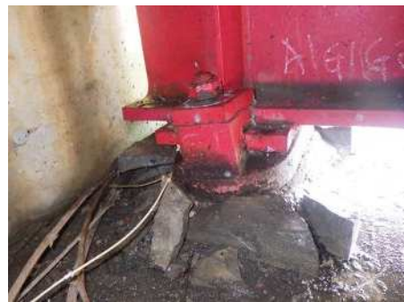
損傷状況（支承傾斜、沓座モルタル欠損）
