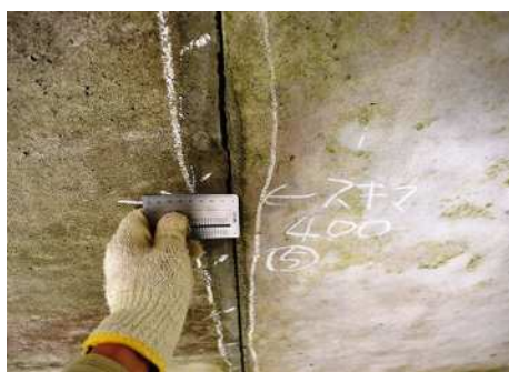
041. 小滝2号橋：ボックスカルバート橋 (橋長：4.00m、1988年竣工) 頂版目地部の隙間 ※地震等の外力により、損傷は進行する可能性がある。(迂回路有り)
