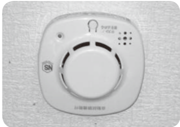
天井に設置された火災警報器
