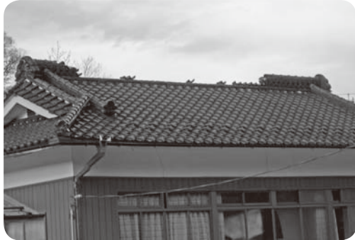
被災した屋根瓦
