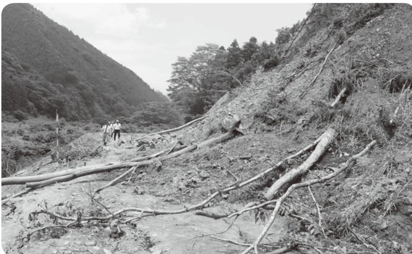
いわき石川線の土砂崩落現場
