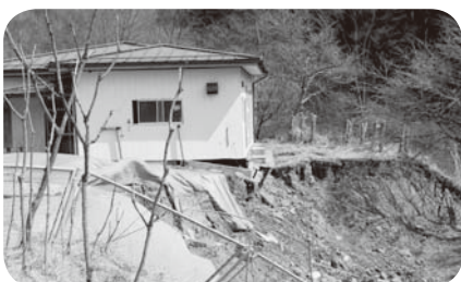
三株団地の法面崩壊現場
