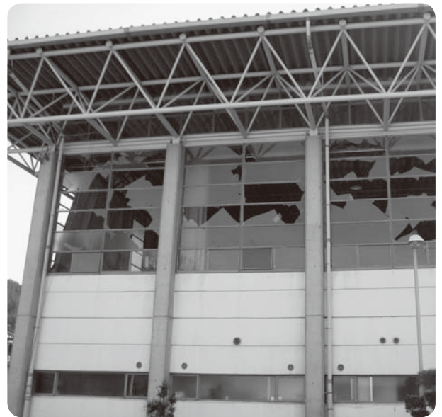
窓ガラスが被災した町民第1体育館
