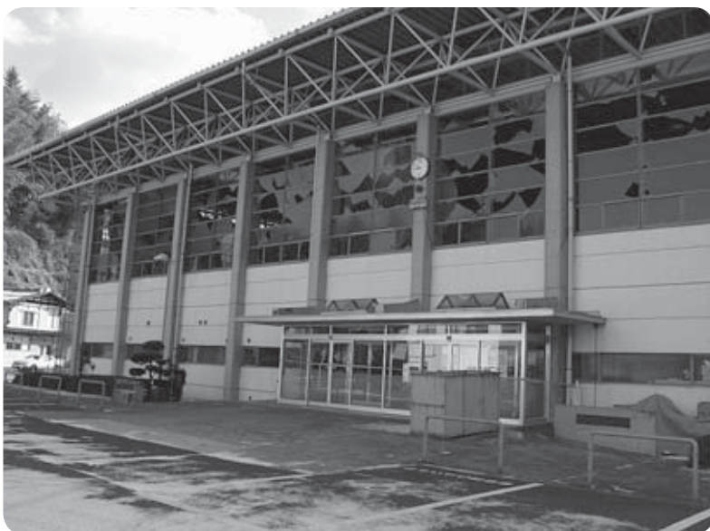
震災で大きな被害を受け建て替えられる町民第1体育館
