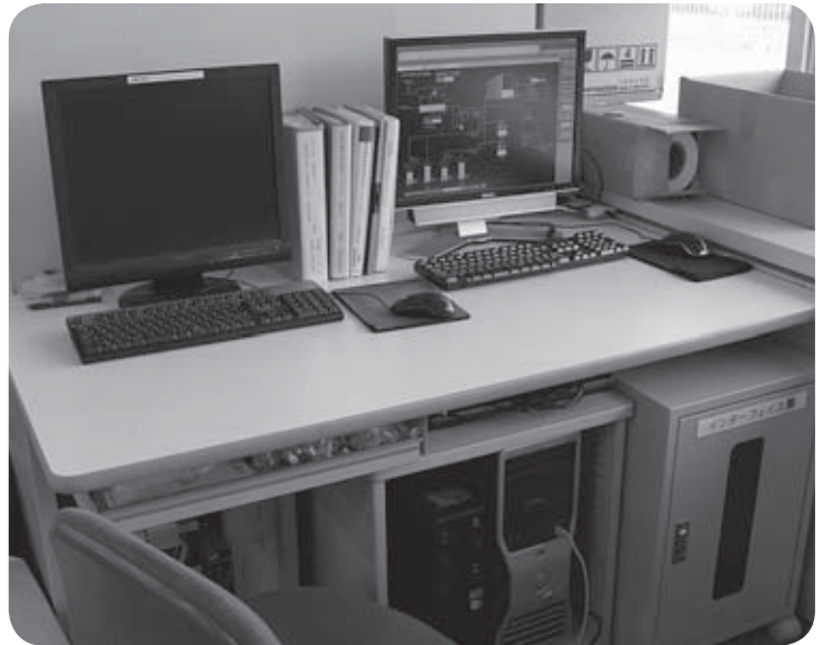
役場庁舎内の水道管理システム
