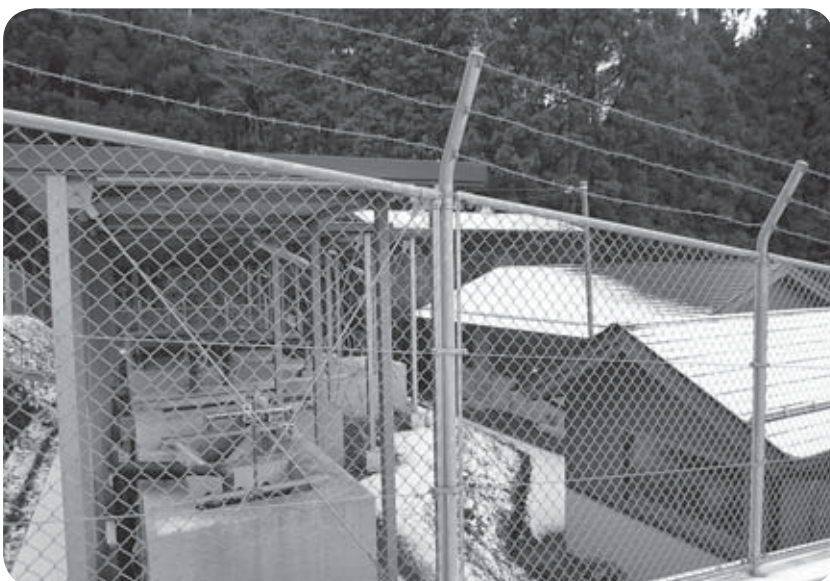
沢浄水場の浄水設備
