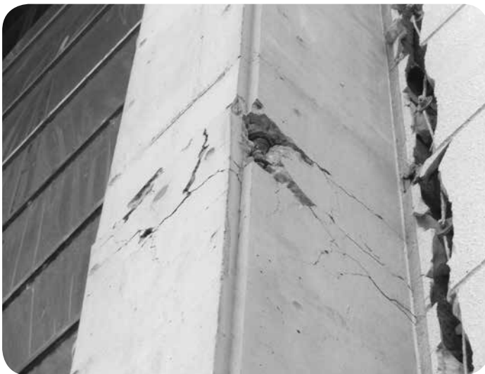
柱・壁の被災跡
