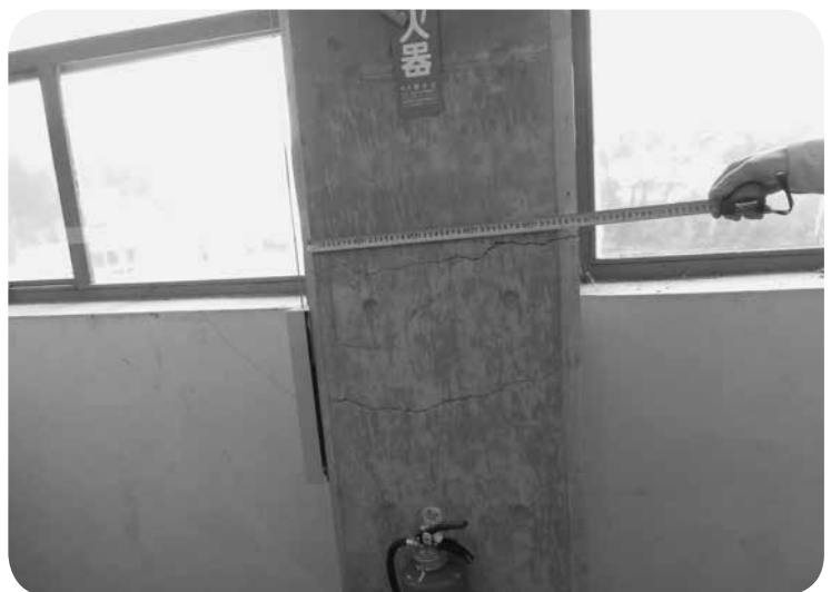
鉄筋コンクリート柱のひび割れ状況
