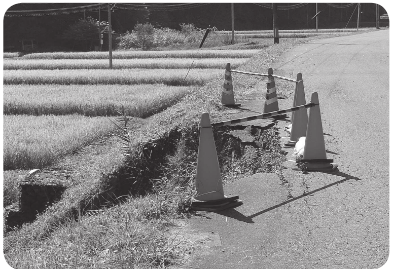
復旧が待たれる町道 松久保鵬巣線路肩崩落現場
