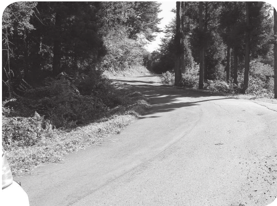
急勾配・急カーブが多い町道 下論田鵬巣線
