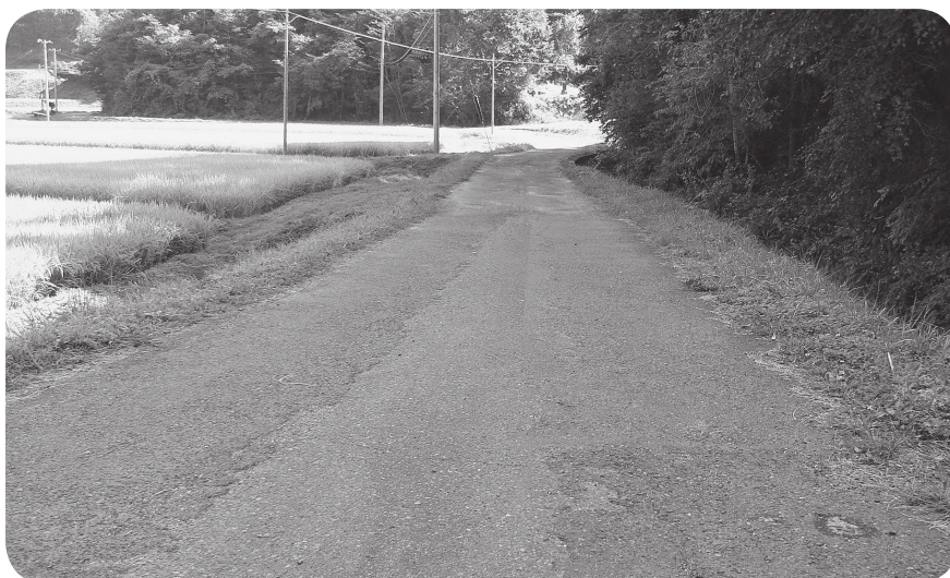
路面の老朽化が進む町道
