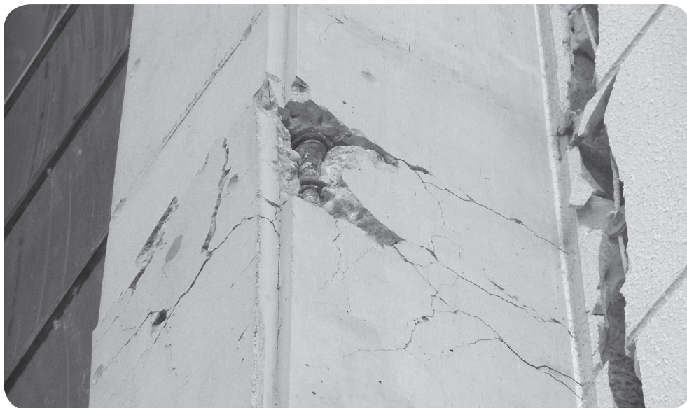
柱の亀裂状況
