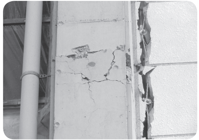
柱と壁の剥離状況
