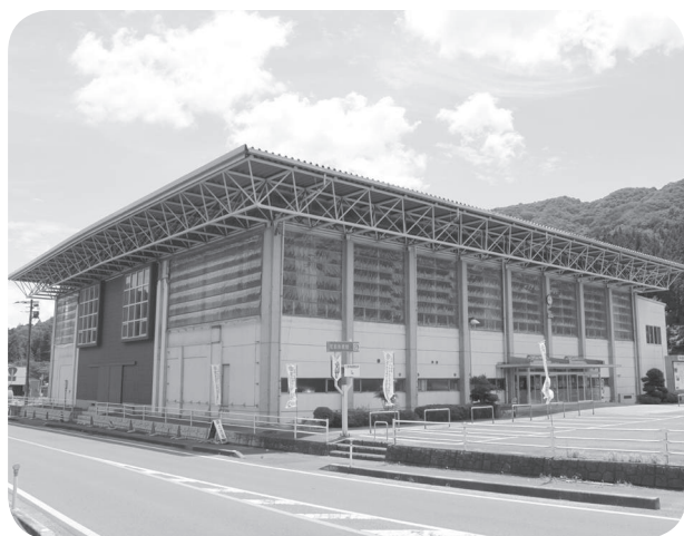
危険建物と判定された町民第1体育館
