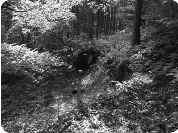
遊歩道の崩落箇所
