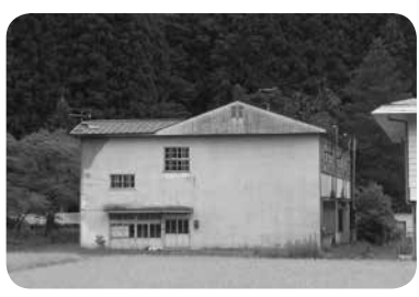
老朽化した旧宮中校舎
