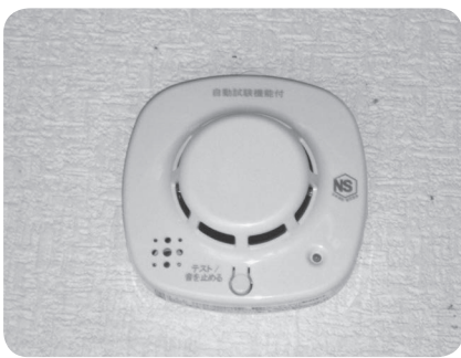
設置義務化されている火災警報器
