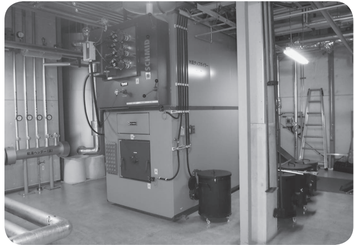
木質バイオマスボイラー（北海道下川町）
