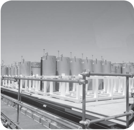
汚染水貯蔵タンク
