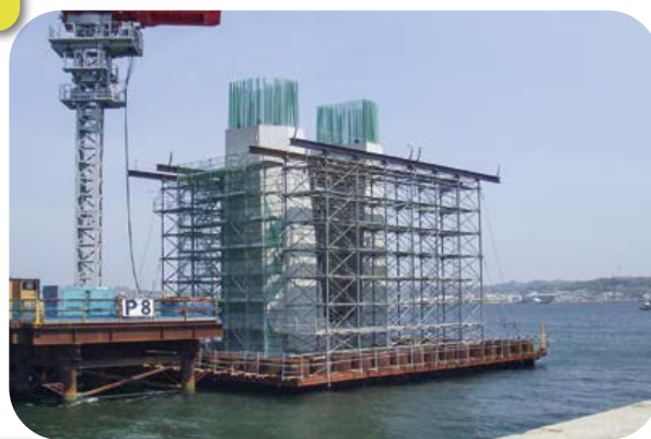
平成29年に鉄筋組み立て工事を行った小名浜マリブリッジ
