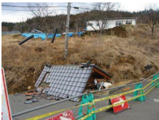
当時の被災状況
