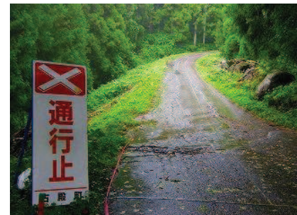
林道薄木線被災箇所
